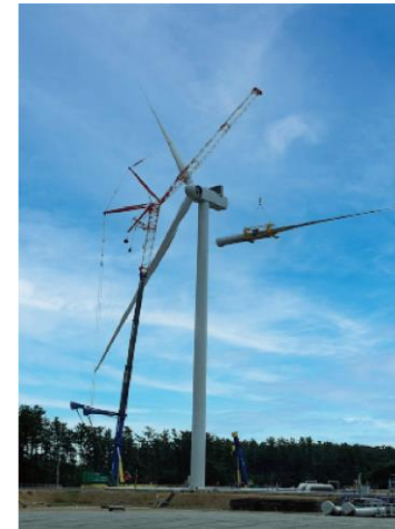
2023年度中には、愛知県田原市に発電出力7,400kWの陸上風力発電所が運転を開始します。
