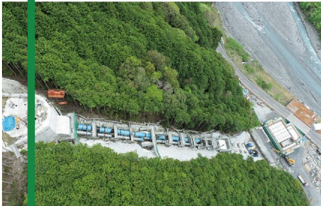
2024年度中の運転開始を目指し、発電出力7,500kWの安倍川水力発電所(静岡市葵区)を建設中です。
