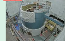
[三重県]宮川第三水力発電所
