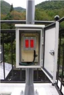
非常用コンセント
