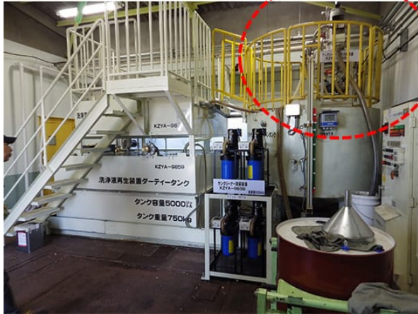
【洗浄液リサイクル室】
