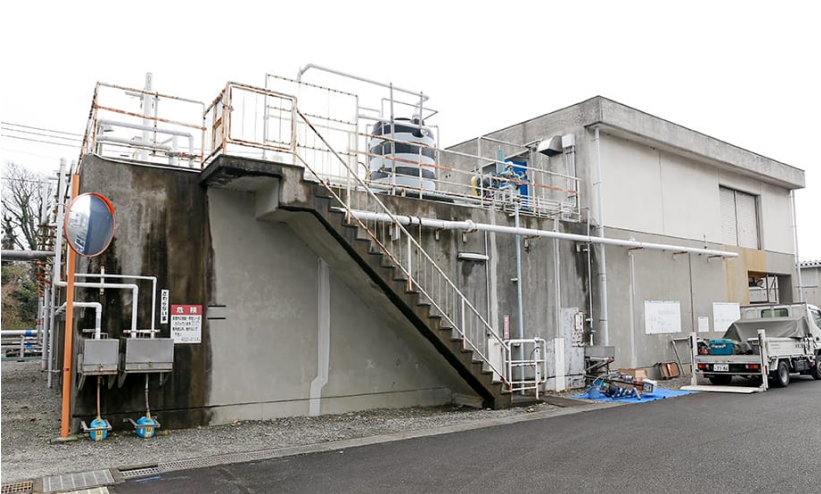
送水ポンプ設備
