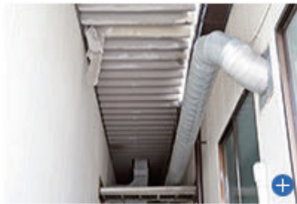
コンプレッサー室から更衣室に配管された排熱利用のダクト
