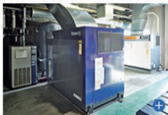
夜間もフル運転するコンプレッサー2台（手前は2014年に導入したインバータータイプ）
