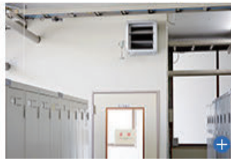
コンプレッサーの排熱は、冬季は工場更衣室の暖房費削減に有効活用
