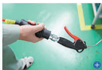
何気なく使っているエアダスタからもエア漏れが見つかった
