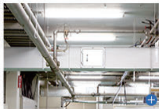
コンプレッサー室から工場内行き渡る圧縮エアの配管
