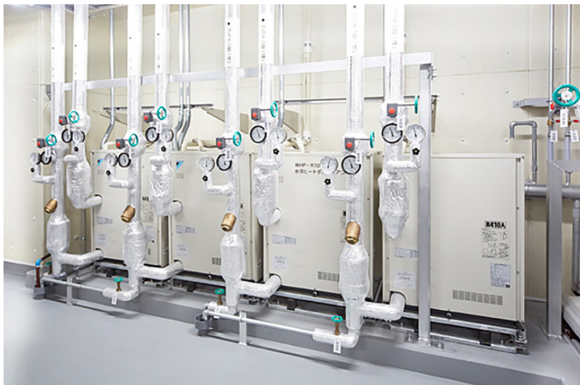
井水を利用した高効率ヒートポンプエアコン
