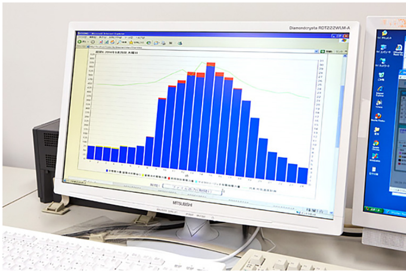
エネルギーの運用状況などは細かく監視。データ化し分析している
