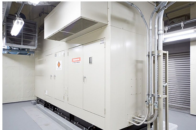
非常用発電機の燃料として軽油5000Lを備蓄
