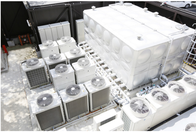
業務用エコキュートのヒートポンプユニット（左）（三菱電機）。 貯湯タンク（右）の容量は47トンと大容量
