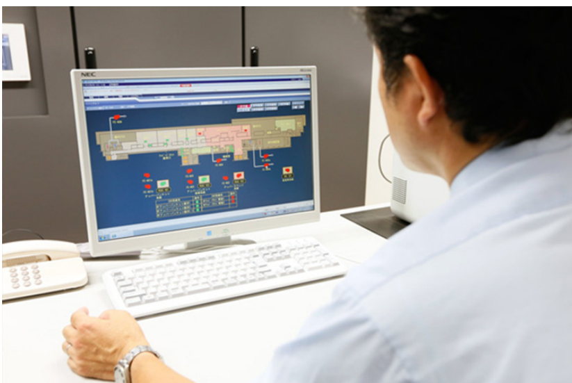
防災センターではモニター画面の切替えて各系統を遠隔管理・制御
