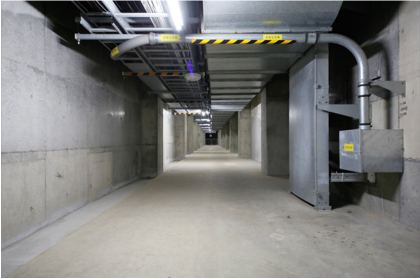
全長180mにも及ぶ風洞。 外気はここを通過だけで地熱により温度コントロールされる
