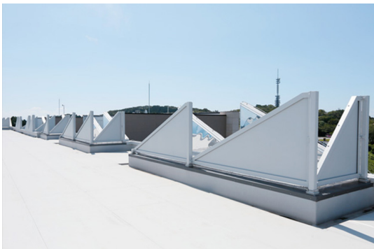
屋上19ヵ所に設置されたライトウェルの採光口。 ミラー反射作用を使う
