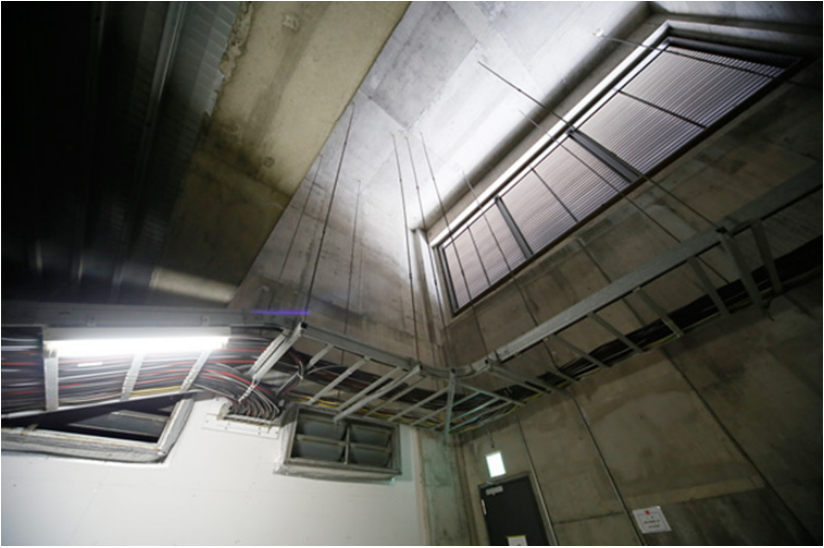
地下のクールヒートトレンチ内部。上の格子状のダクトから給気ファンで外気を取り込んでいる
