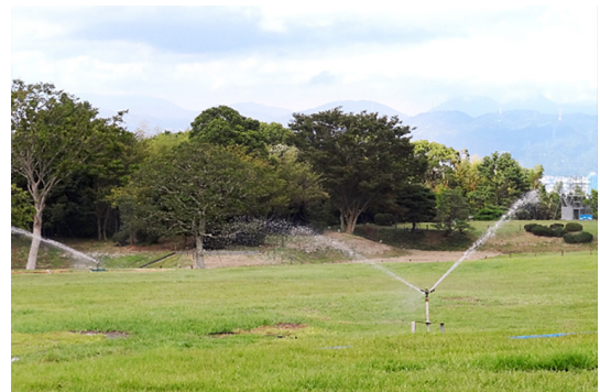
貯水槽に溜められた雨水は植栽の散水に利用
