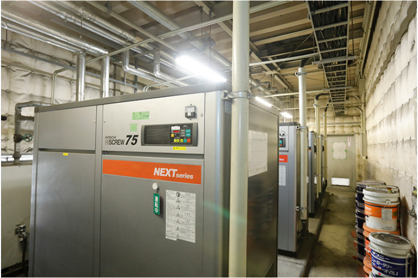
コンプレッサは2つの設備室に6台設置。
